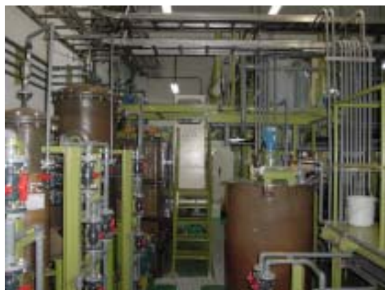
無機廃液処理装置 (同和工営製、鉄粉法)
