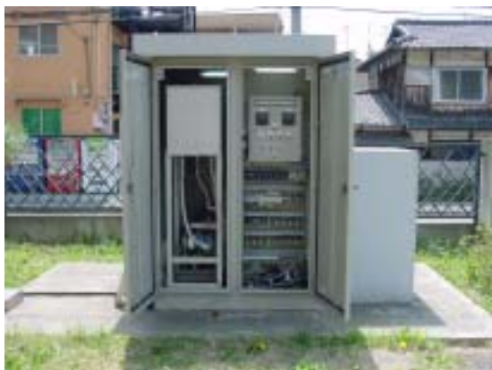
排水モニター室（松ヶ崎団地西地点）
