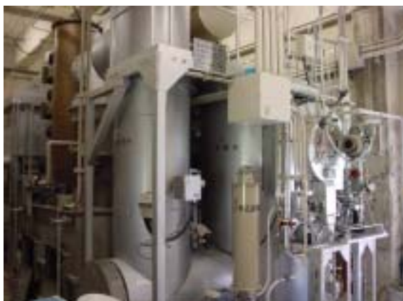
有機廃液焼却処理装置 (サンレー冷熱製、噴霧燃焼法)
