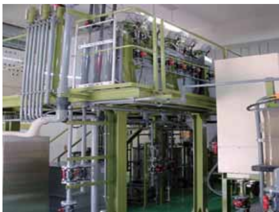
無機廃液処理装置
