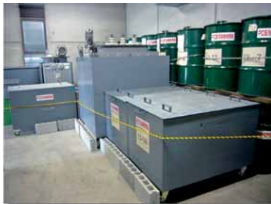
低濃度 PCB 廃棄物の保管
