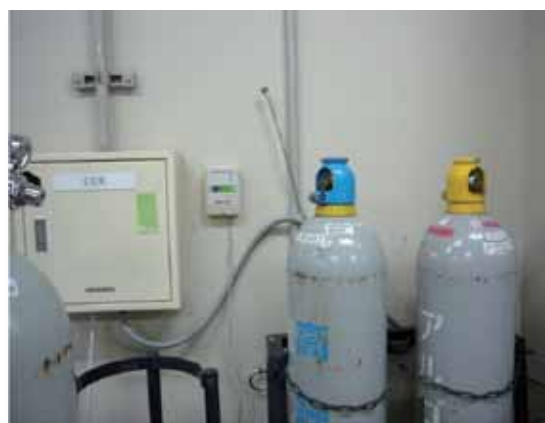
ガスボンベと酸素濃度計
