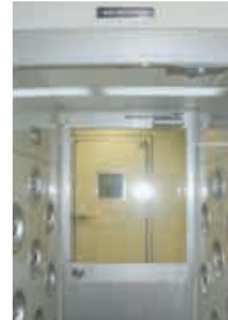
バイオクリーンルーム入口
